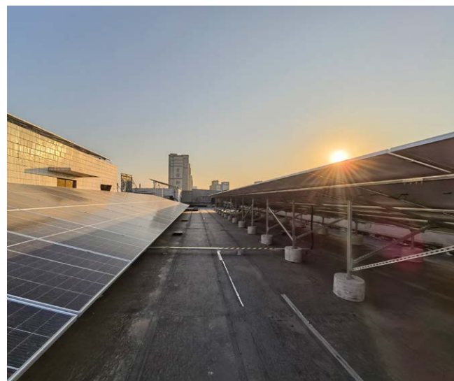
> 安阳公司办公大楼楼顶光伏发电项目
